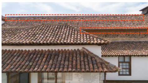
CUBIERTA DE LA NAVE (HACIA CLAUSTRO DEL CENOBIO) - DESPLAZAMIENTO DE LA CAPA DE COBERTURA Y GRIETA LINEAL BAJO EL ALERO
