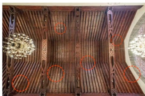
INTERIOR DE LA CUBIERTA DE LA NAVE CERCA DE LA CAPILLA - FILTRACIONES
