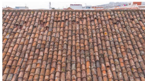
CUBIERTA DE LA NAVE (HACIA CLAUSTRO DEL CENOBIO) - DESPLAZAMIENTO DE LA CAPA DE COBERTURA
