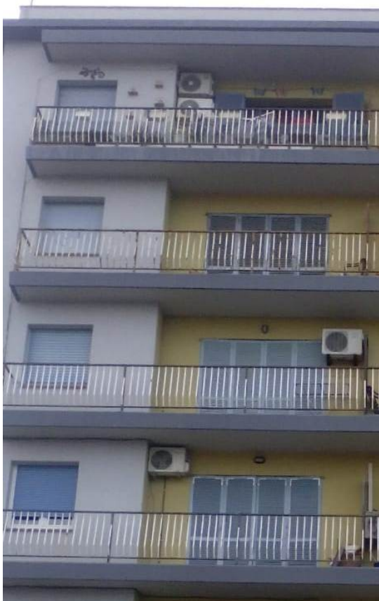
Exemple d'instal·lació a evitar
