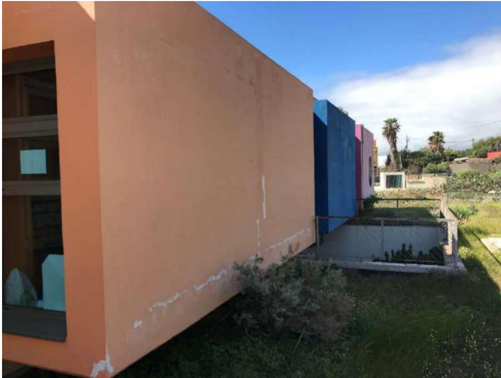
Estado actual de módulos de color que requieren pintura de paramentos Casa de Juventud de El Rosario. EL Chorrillo. 1 de abril de 2022
