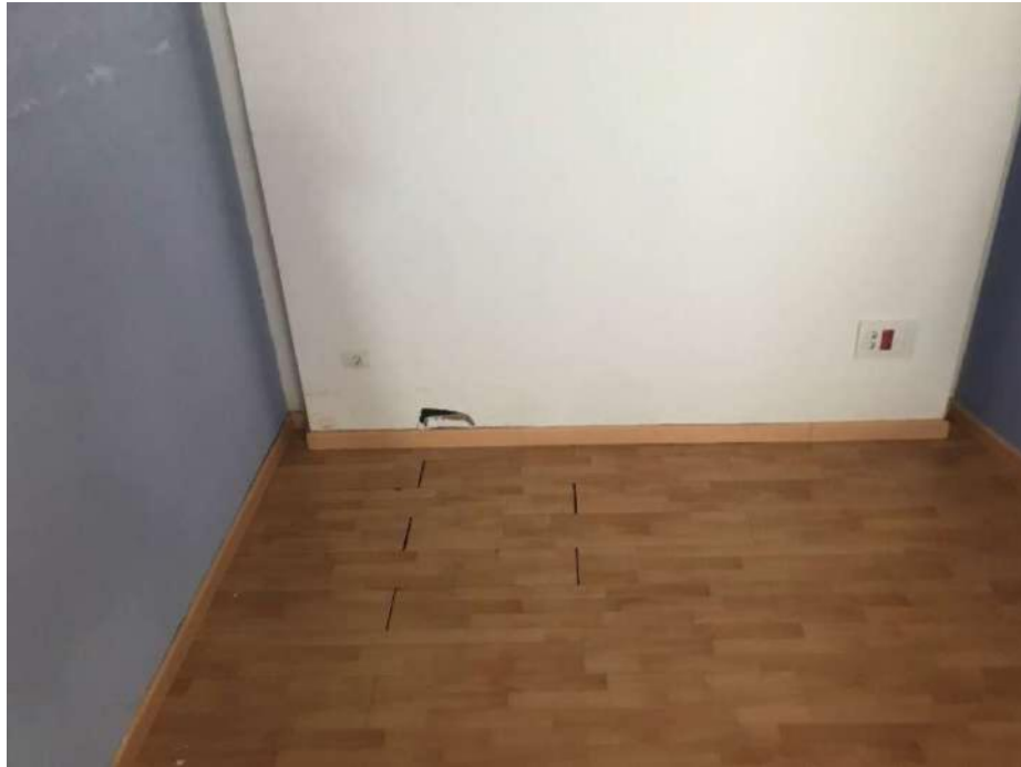
Pavimento de madera levantado, bajo escalera de acceso a cubierta. Casa de Juventud de Santiago del Teide. 20 de mayo de 2022.
