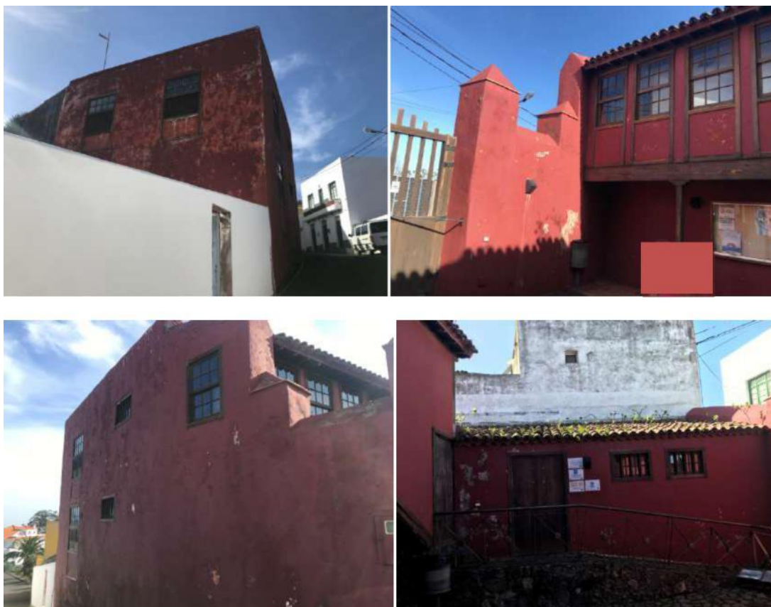
Estado actual de la fachada y cerramientos exteriores de la Casa de Juventud de El Tanque. 14 de diciembre 2021
