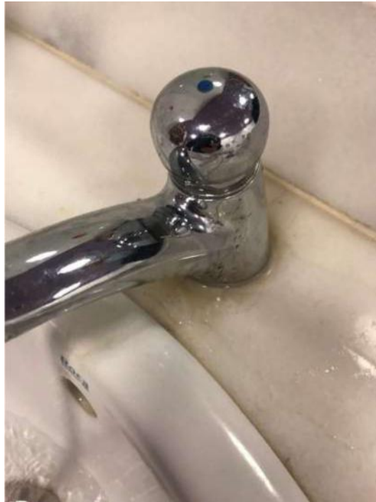
Grifo defectuoso. Casa de Juventud de El Rosario. EL Chorrillo. 1 de abril de 2022.
