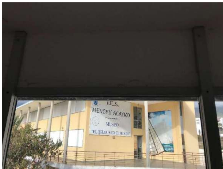
Desperfecto en paramento vertical situado sobre carpintería de aluminio en fachada. Planta Alta. Casa de Juventud de Casa de Juventud de Güímar. 1 de abril de 2022
