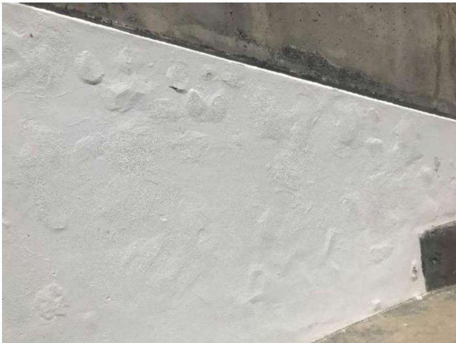
Humedad en paramento vertical, bajo escalera de acceso a cubierta. Casa de Juventud de Santiago del Teide. 20 de mayo de 2022.
