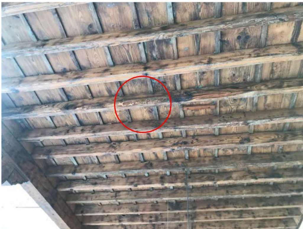
Deterioro de par en corredor realizado por agentes xilófagos. 21 de enero de 2022.
