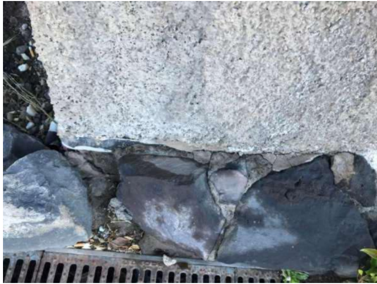
Estado actual de remate de impermeabilización de muro de contención trasero. Casa de Juventud de Guía de Isora. 2 de marzo de 2022.
