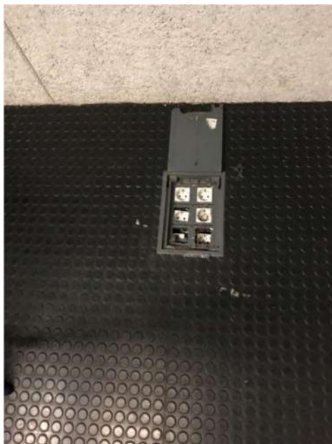
Estado de puesto de trabajo (instalación eléctrica) en sala de ensayos 22 12 2021
