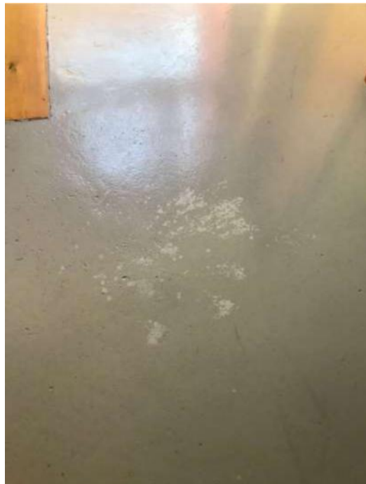
Estado de pavimento de resina entre habitaciones 1 y 2. Está manchado. Requiere reparación. Casa de Juventud de Guía de Isora. 2 de marzo de 2022.
