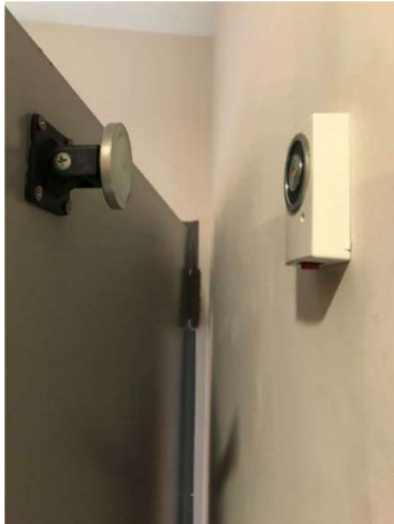
Estado de retenedor electromagnético. 21 de enero de 2022
