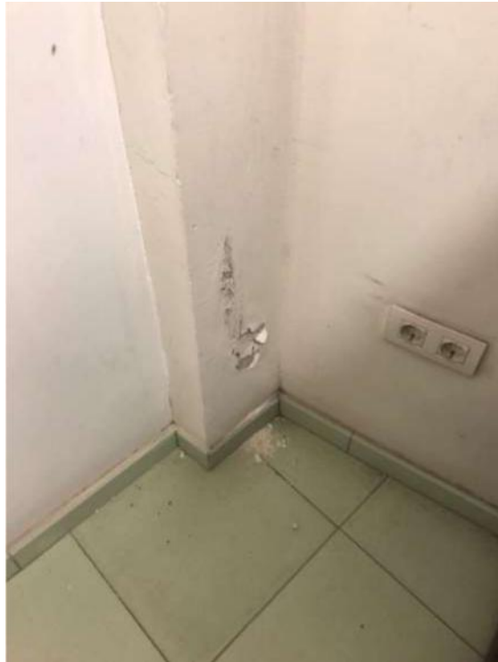
Pilar de habitación de UPS.21 de enero de 2022.
