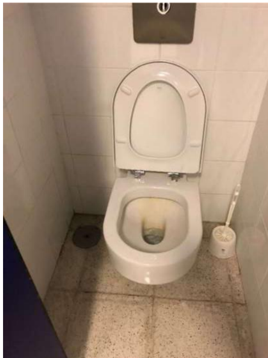
Inodoro con pérdidas de agua. Casa de Juventud de El Rosario. EL Chorrillo. 1 de abril de 2022.
