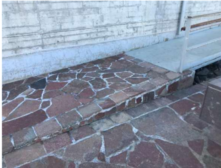
Estado de inicio de pasarela exterior de acceso directo al Albergue. Casa de Juventud de Guía de Isora. 2 de marzo de 2022
