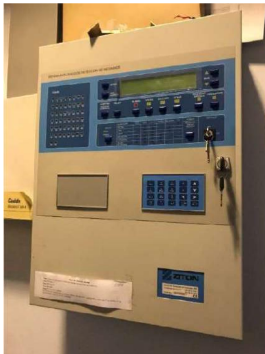
Sistema de detección de incendios. Casa de Juventud de Güímar. 1 de abril de 2022.
