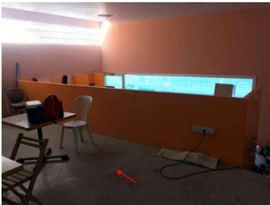
Localización de grietas en el pavimento de hormigón
