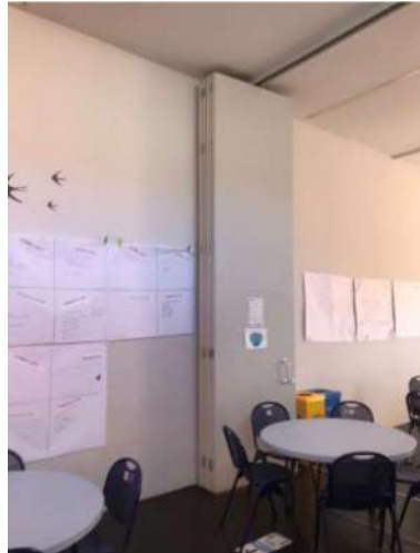
Puerta plegable en sala multiusos. 22 12 2021
