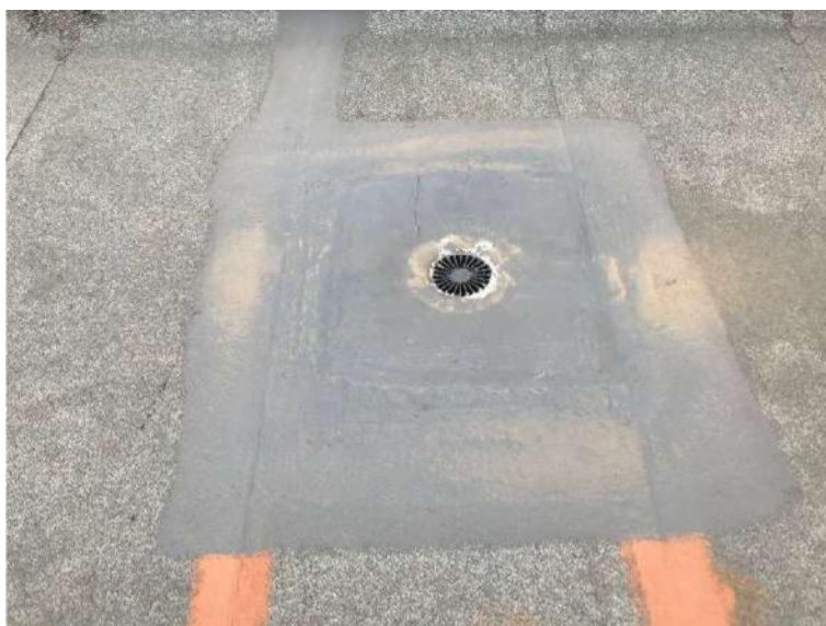
Estado de Cazoleta situada en cubierta, precisa ser reparada su impermeabilización.. Granadilla de Abona. 7 de marzo de 2022.
