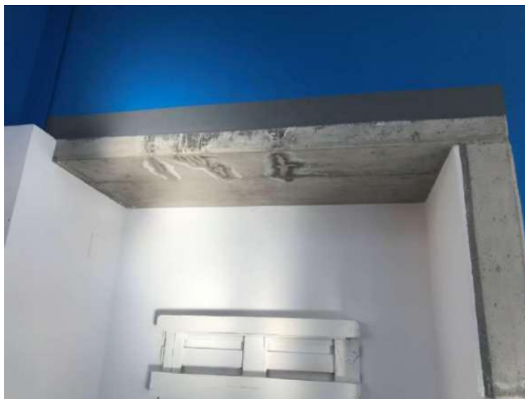
Humedad en losa. 2 de marzo de 2022.
