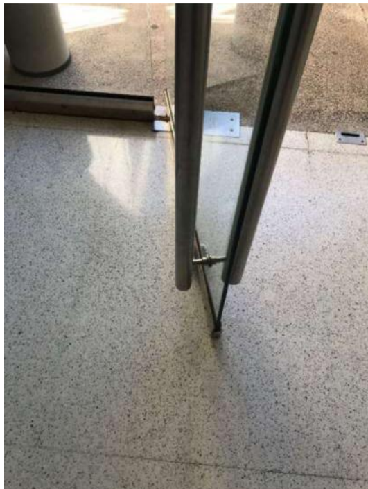
Puerta de vidrio en acceso principal, mal ajustada. Casa de Juventud de El Rosario. EL Chorrillo. 1 de abril de 2022
