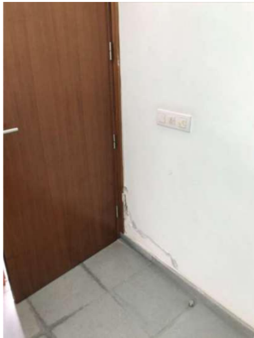
Estado actual de humedad en salida trasera de la casa. 18 de enero 2022.
