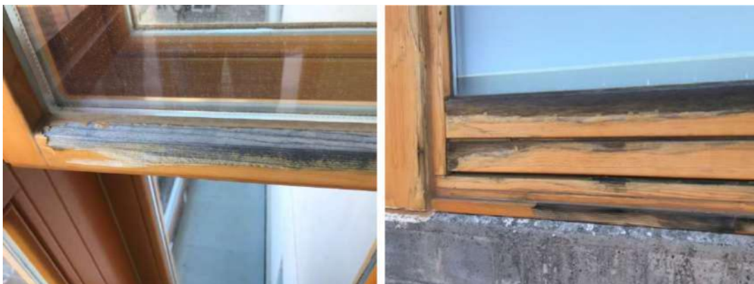
Estado actual de algunas carpinterías de madera. Casa de Juventud de Guía de Isora. 2 de marzo de 2022
