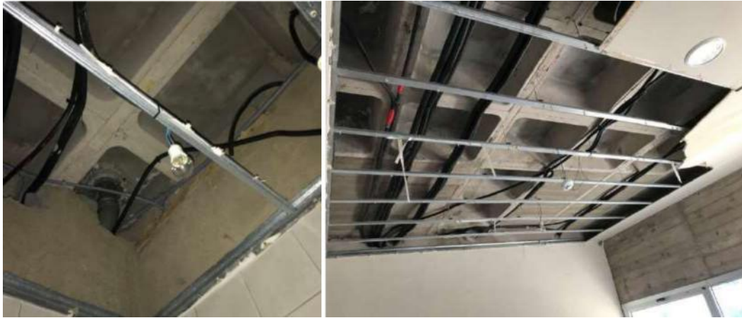
Estado actual de falsos techos de la casa de Juventud de Los Silos. 22 diciembre 2021
