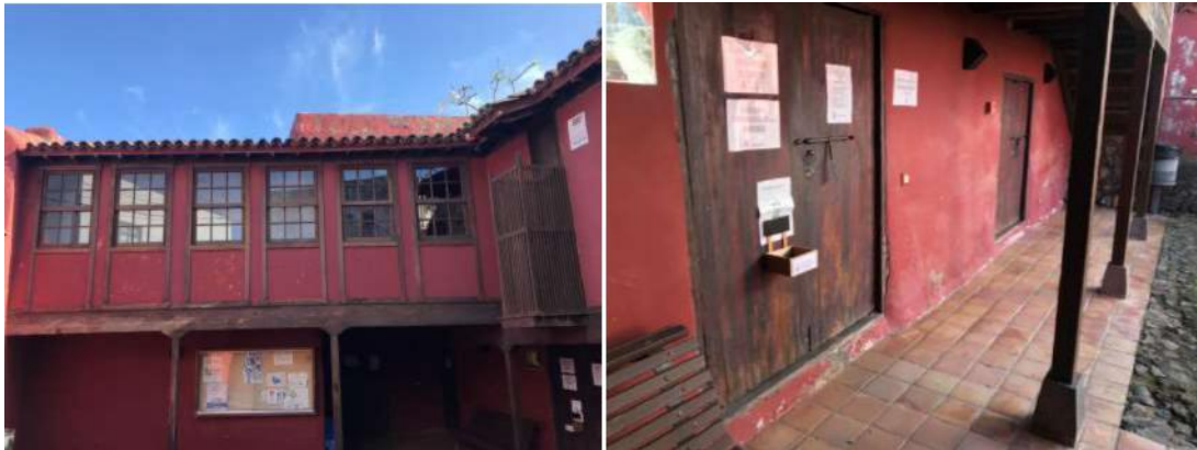
Estado actual de la carpintería exterior y cerramientos de la Casa de Juventud de El Tanque. 14 de diciembre 2021
