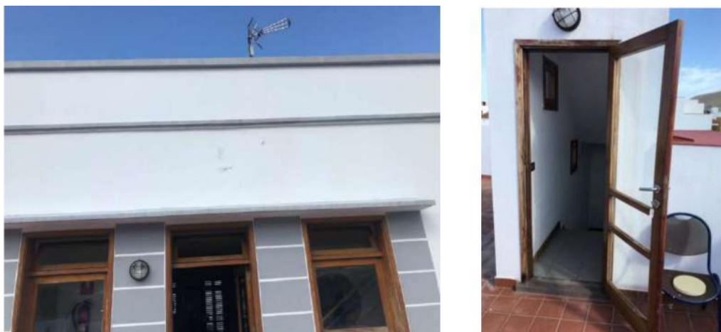
Estado actual de la carpinterías de madera en terraza de planta primera y salida a cubierta. 14 de diciembre de 2021.
