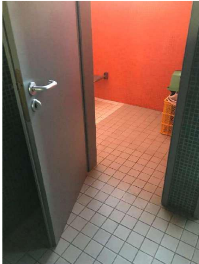
Estado actual de puerta de baño en albergue que tropieza al abrir. Casa de Juventud de Casa de Juventud de Güímar. 1 de abril de 2022.
