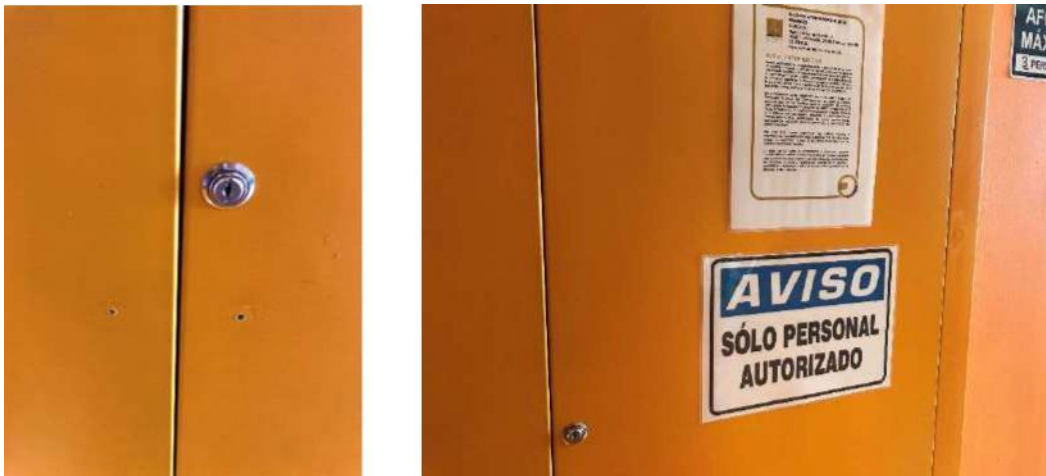
Estado actual de la puerta de acceso a cuadro eléctrico, sin tiradores. Casa de Juventud de El Rosario. EL Chorrillo. 1 de abril de 2022
