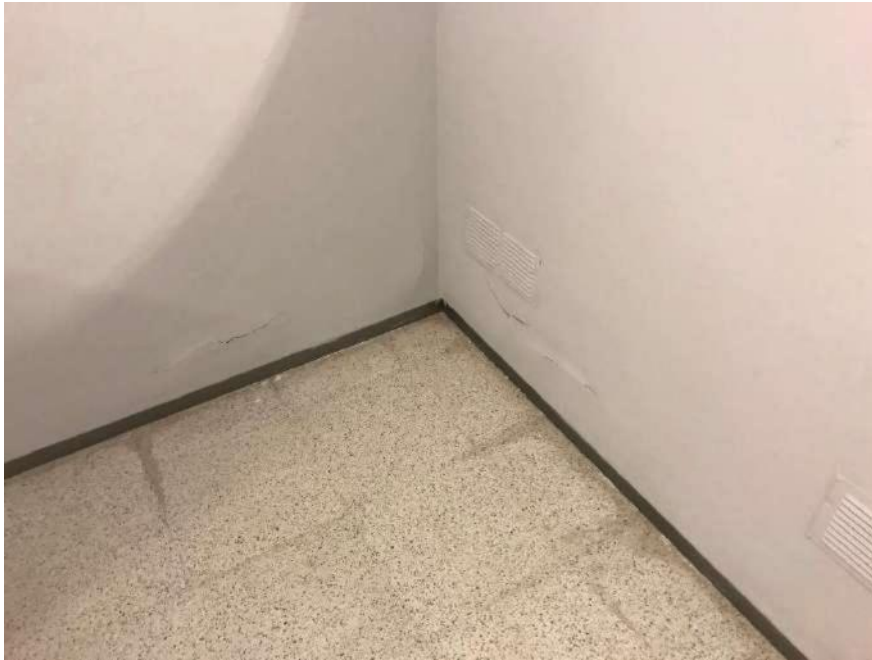
Humedad en pasillo. Casa de Juventud de El Rosario. EL Chorrillo. 1 de abril de 2022.
