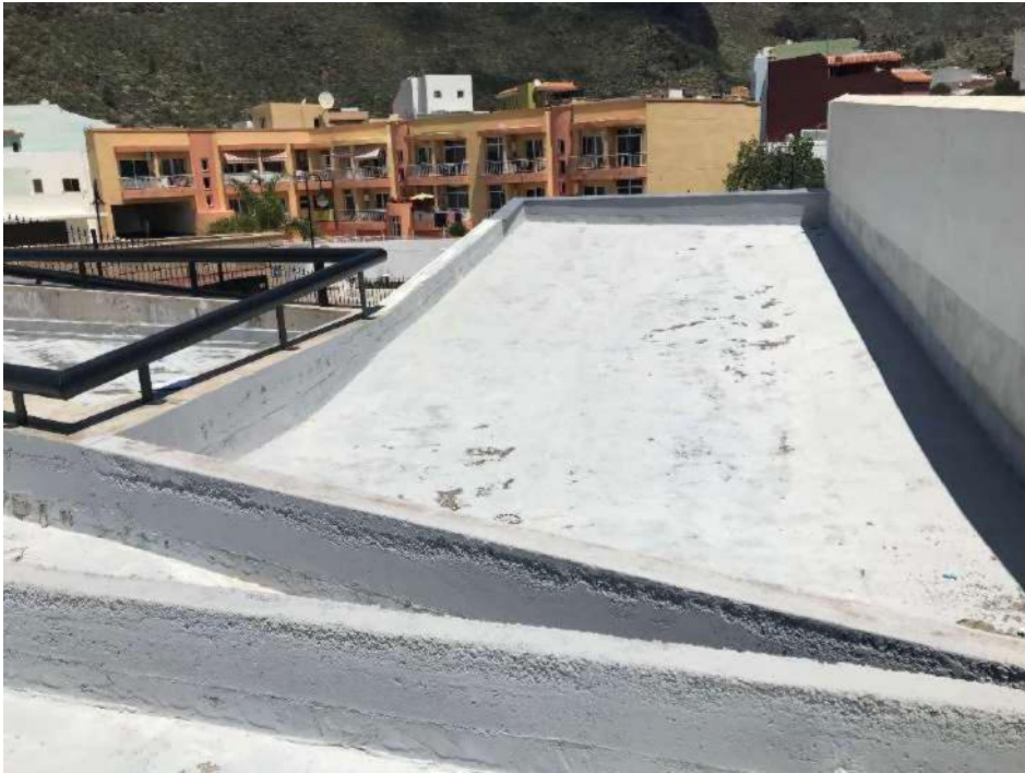
Impermeabilizar cubierta. Casa de Juventud de Santiago del Teide. 2 de mayo de 2022
