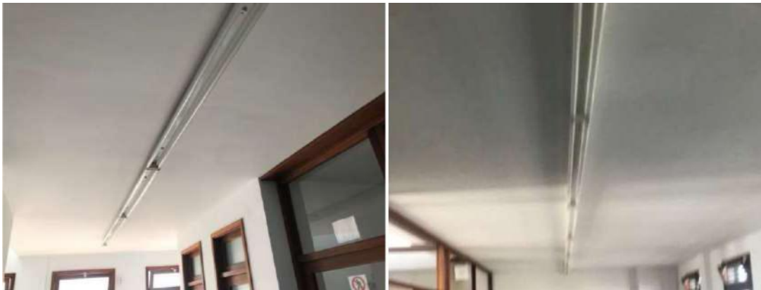
Luminarias actuales, tubos fluorescentes. 14 de diciembre 2021.
