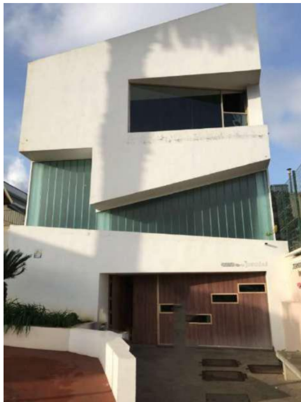
Estado actual de fachada trasera de la casa de juventud de La Orotava. 18 de enero 2022.
