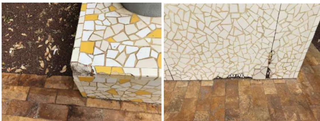
En algunas zonas se ha perdido piezas del revestimiento y deben ser repuestas. El Fraile. 7 de marzo de 2022.
