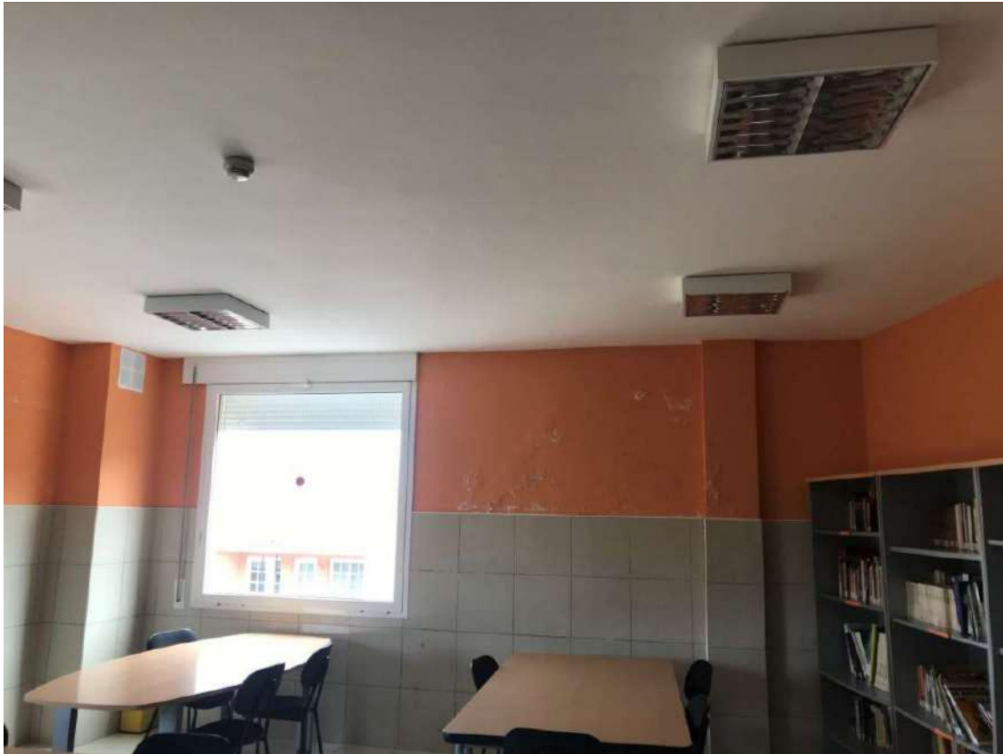
Luminarias actuales. 21 de enero de 2022.
