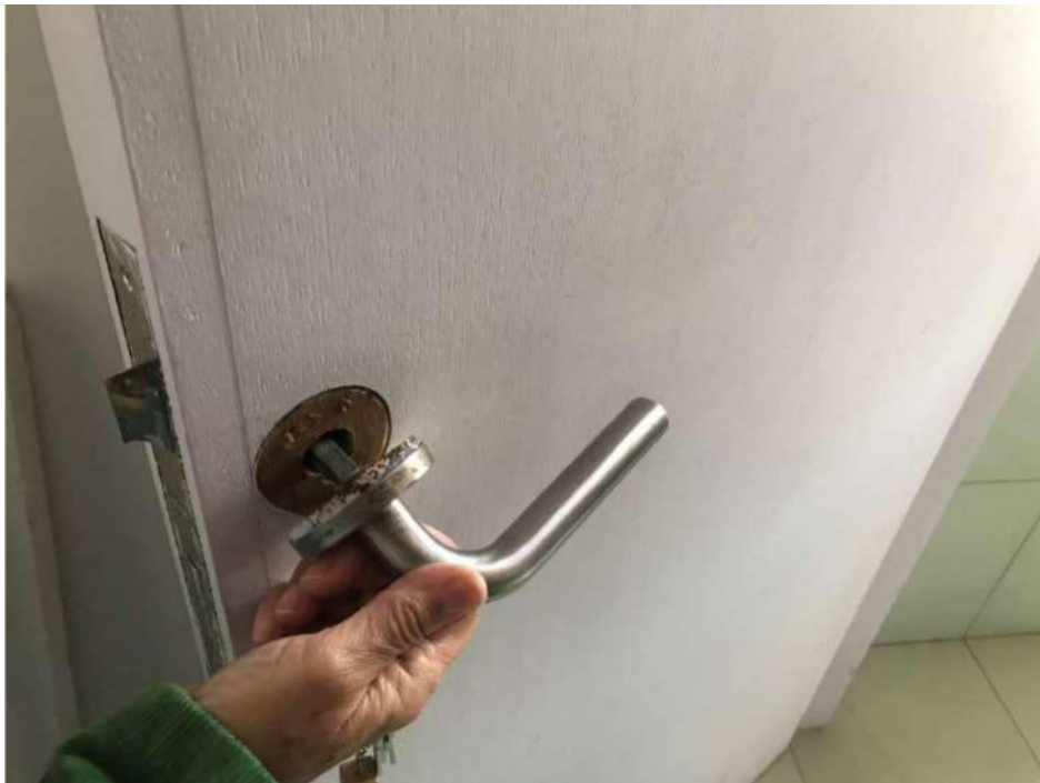
Manecillas de puerta de almacén en Salas de ensayos. 21 de enero de 2022.
