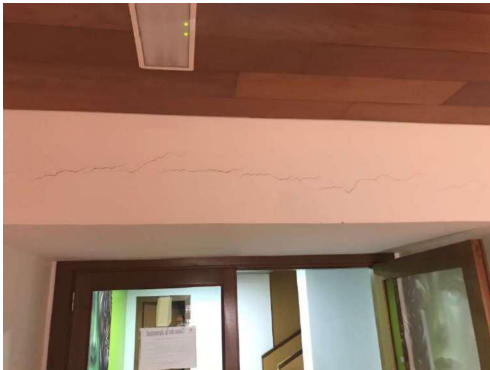
Grieta en dintel de acceso a mediateca. 18 de enero de 2022.
