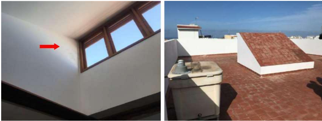
Lucernario donde se aprecia humedad (flecha roja). 14 de diciembre de 2021.
