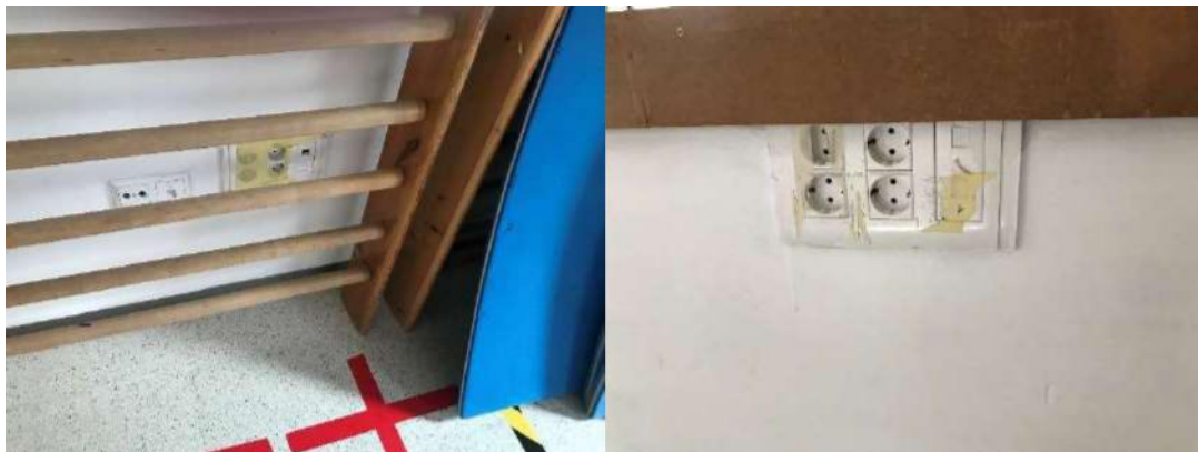
Cajas de tomas de corriente que no funciona. Casa de Juventud de El Rosario. EL Chorrillo. 1 de abril de 2022
