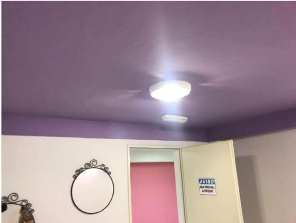
Falta difusor en plafón de camerinos. Casa de Juventud de El Rosario. EL Chorrillo. 1 de abril de 2022
