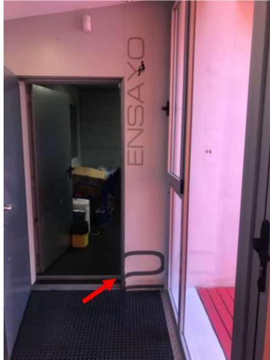
Panel de revestimiento de DM en acceso a local de Ensayo. 22 diciembre 2021
