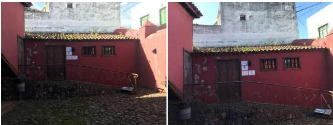
Estado actual de la pavimentación del patio. 14 de diciembre de 2021.
