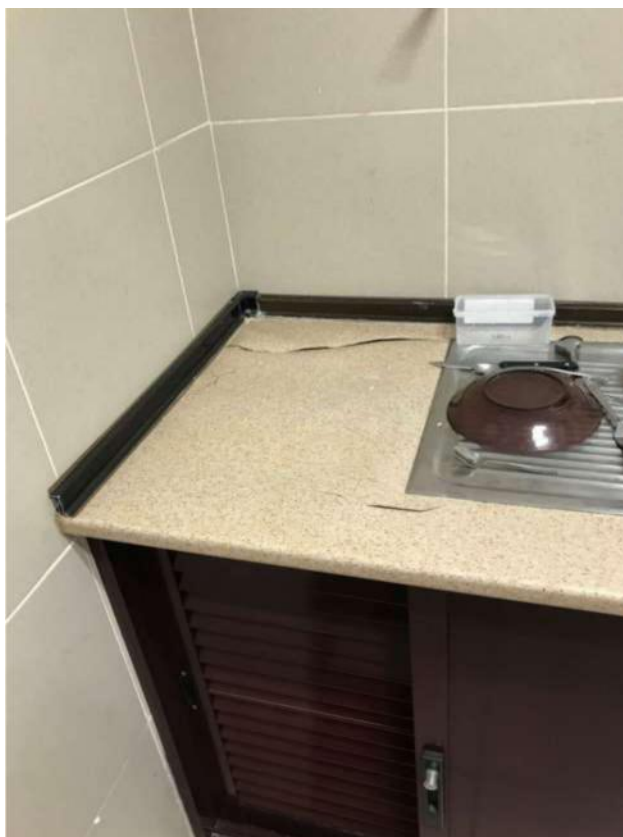
Vista de la encimera deteriorada. Casa de Juventud de la Matanza de Acentejo 16 de febrero 2022.
