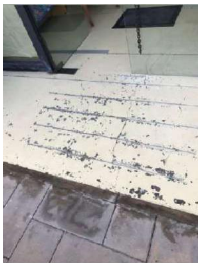
Estado actual del pavimento exterior. 14 de diciembre de 2021.
