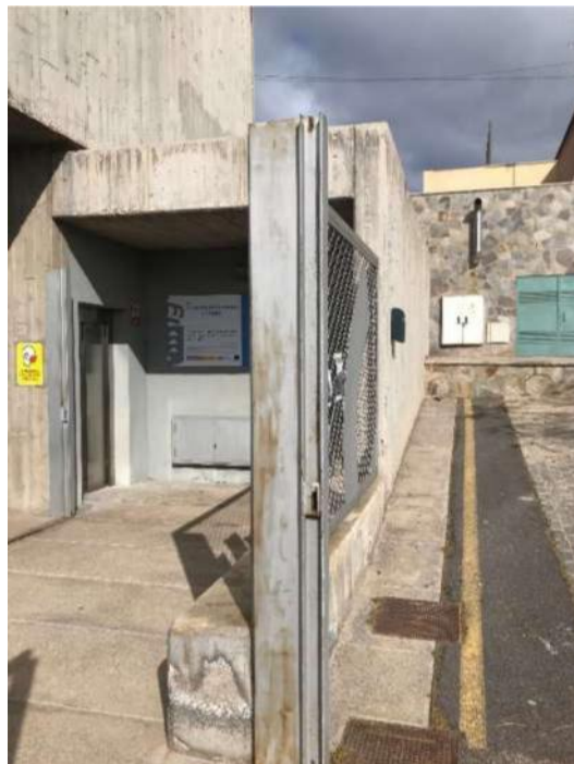
Estado actual de cerrajería exterior que requieren pintura. Casa de Juventud de El Rosario. EL Chorrillo. 1 de abril de 2022
