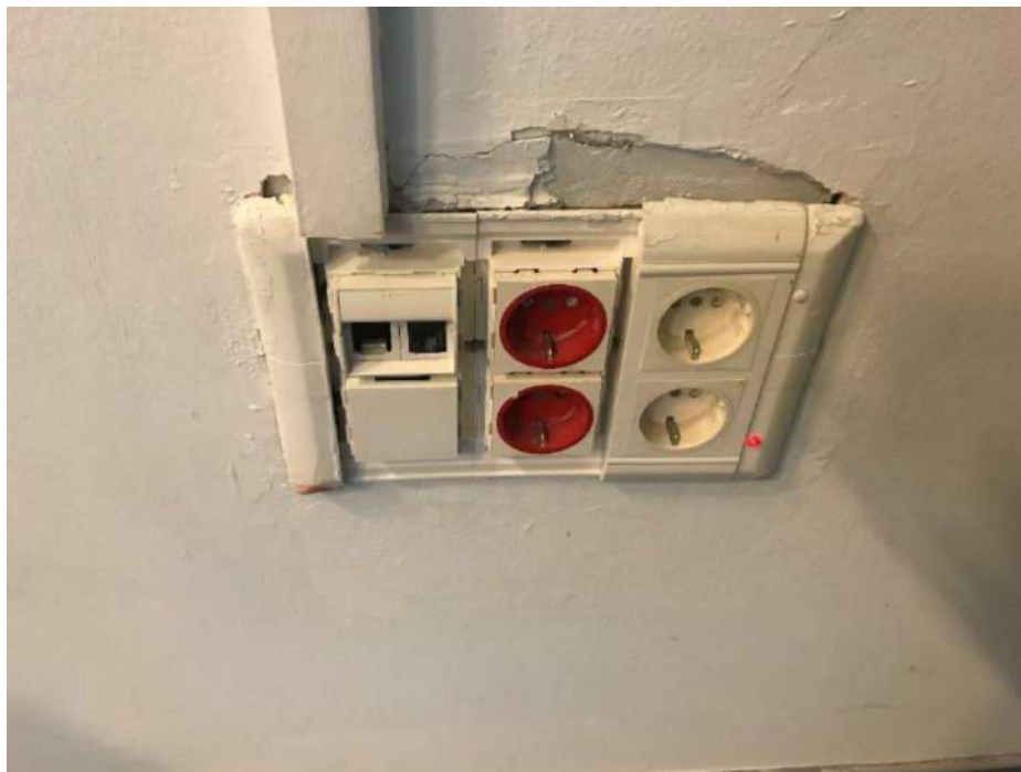
Toma eléctrica deteriorada. Casa de Juventud de Güímar. 1 de abril de 2022.
