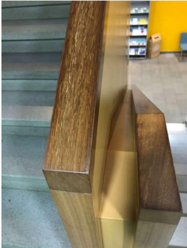
Estado actual de pasamanos de escalera principal. 18 de enero de 2022
