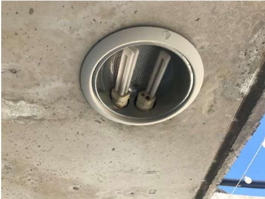
Luminaria actual en acceso Casa de Juventud de Santiago del Teide. 20 de mayo de 2022.
