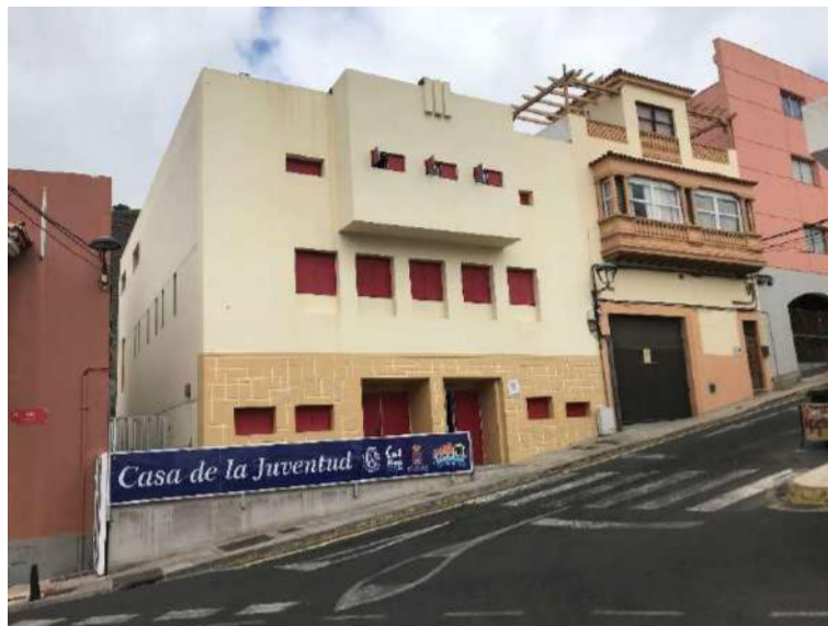
Estado de la fachada principal de la Casa de la Juventud. Necesita ser pintada. Granadilla de Abona. 7 de marzo de 2022.
