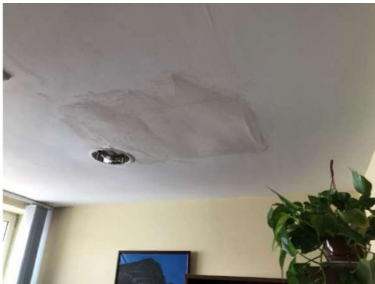
Estado de techo de despacho de Concejala. Necesita reparación y pintura. Granadilla de Abona. 7 de marzo de 2022.
